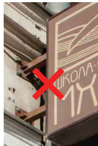
Покрите іржею кріплення впадає в очі та встановлене на непідготовленій ділянці фасаду (видні отвори від кріплень попередньої вивіски)
